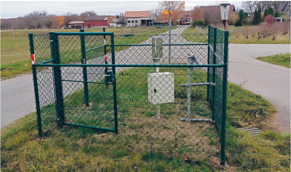
Fig. X.2.1 Pluviomètre à auget basculant, récemment installé à Essertines (canton de Genève). Photo : Office cantonal de l'eau, Genève
